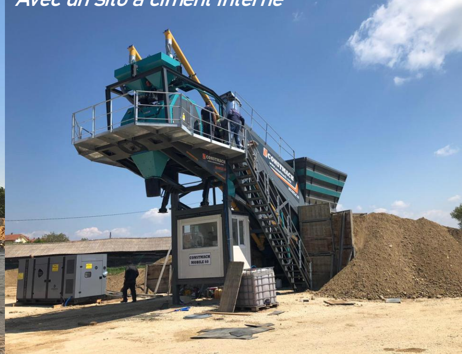
Avec un silo à ciment interne
